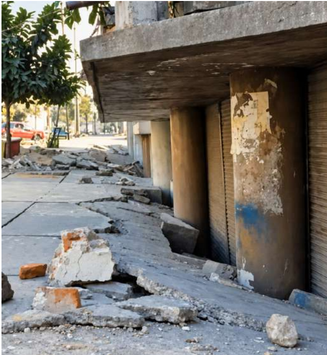
Figura 2 Falla de cimentación superficial en la Ciudad de México durante el sismo de 1985. Fuente: Auvinet Guichard (2018).
