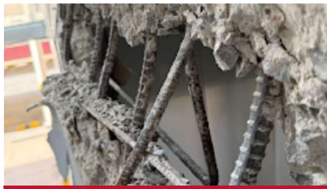
Figura 8. Fallas en conexiones losa-muro en edificaciones con muros delgados (J. Rincon).
