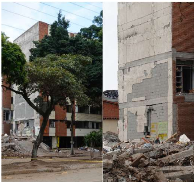
Foto 7. Inclinación hacia el sur y hacia el oriente (Fotos: Zulma S. Pardo V.)
