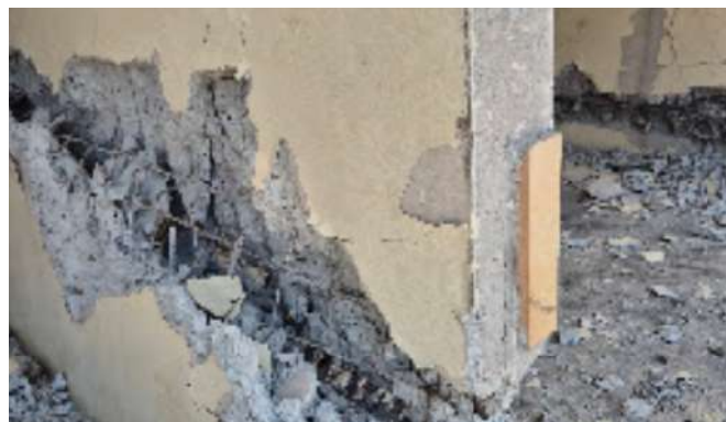
Figura 6. Falla en muro de 15 cm con traslapes en su base (CEER).
