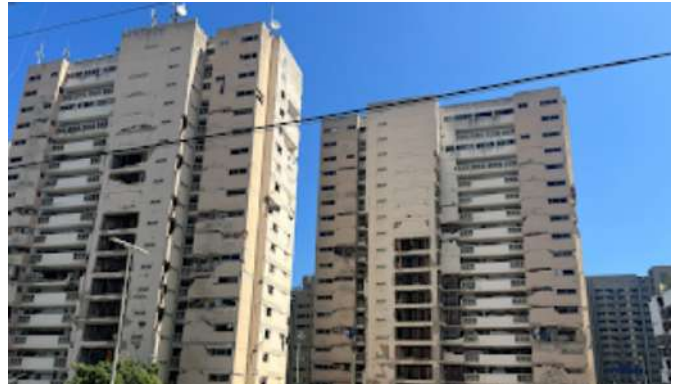
Figura 2. Pórtico aparentemente dúctil con daño excesivo en fachadas
