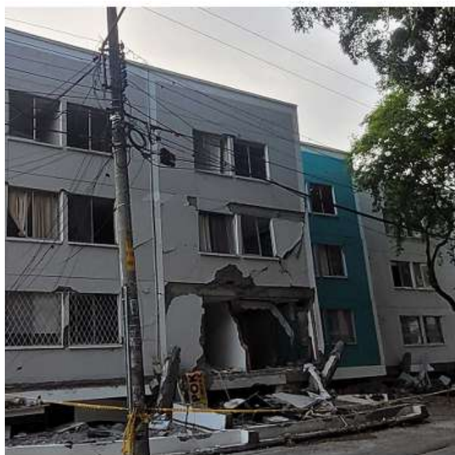
Foto 16. Falla de piso débil. Costado Oriente (Foto: Zulma S. Pardo V.)
