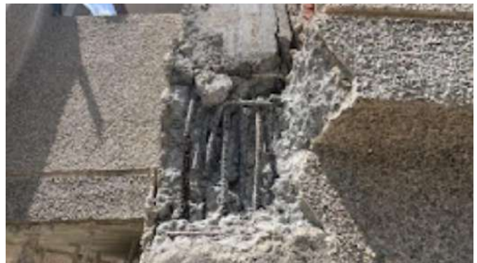
Figura 4. Falla por falta de acero de confinamiento en junta vigacolumna (nótese también acero de viga por fuera de refuerzo en columna).
