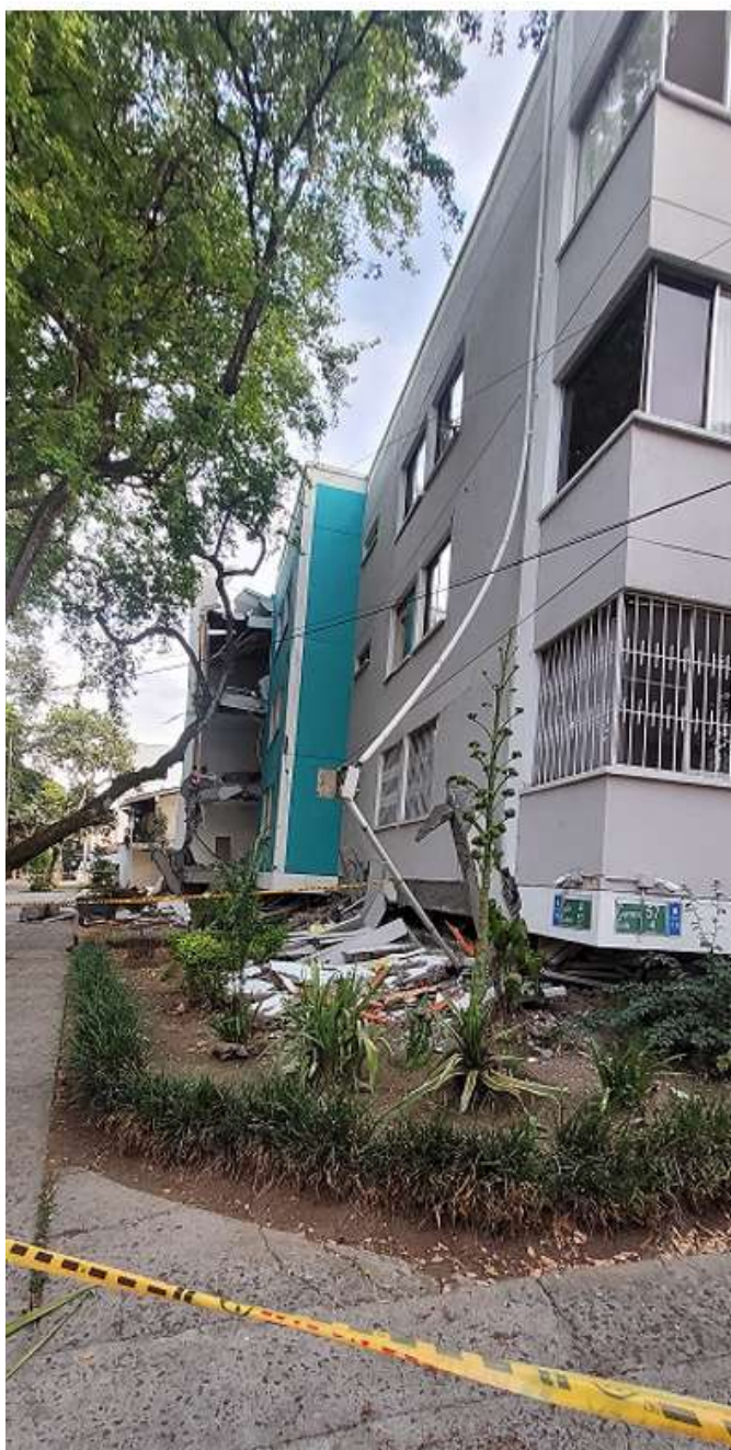
Foto 15. Falla de piso débil. Costado oriente (Foto: Zulma S. Pardo V.)
