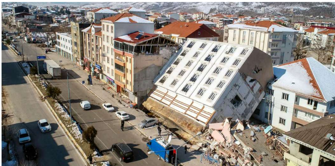
Figura 1 Edificio inclinado, aparentemente por licuación, en Kahramanmaraş, Turquía, tras los sismos de 2023. Fuente: Torres Álvarez (2023).
