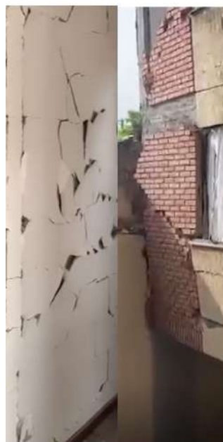
Foto 8. Daños en muros interiores y fachadas interiores (Ref: (minutos, 2026))
