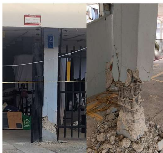
Foto 12. Edificio Caso 3. Articulaciones plásticas (Fotos: Zulma S. Pardo V., Arq. Fernando Solarte)
