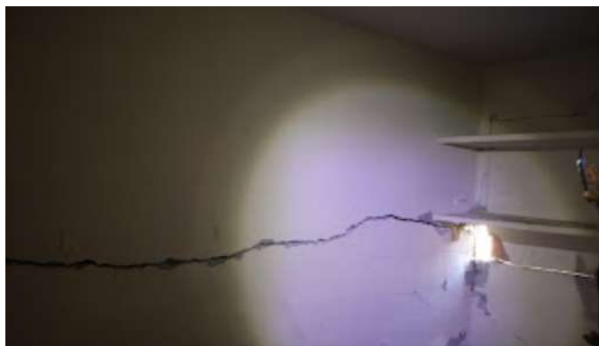
Figura 5. Falla de tracción por falta de acero longitudinal en muro estructural con cuantía de 0.18% (foto de R. Bonett).
