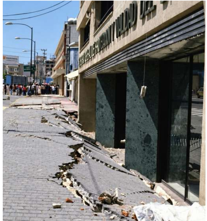
Figura 3 Asentamiento de un edificio en la Ciudad de México durante el sismo de 1985. Fuente: Díaz-Rodríguez (2026).
