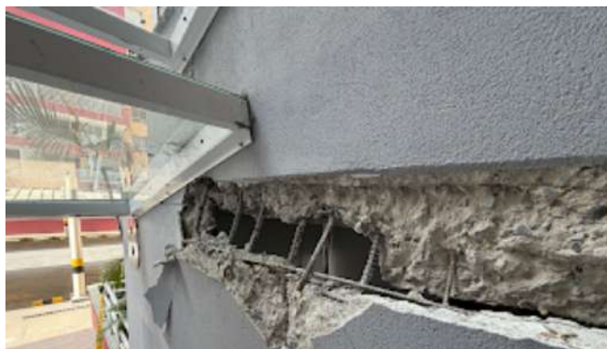
Figura 7. Posible falla de arrancamiento (breakout)
